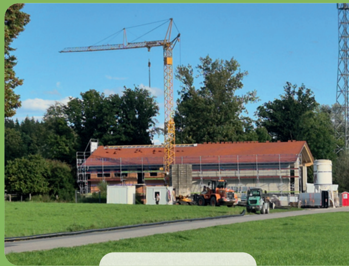
Die neue Heizzentrale in Polling.
